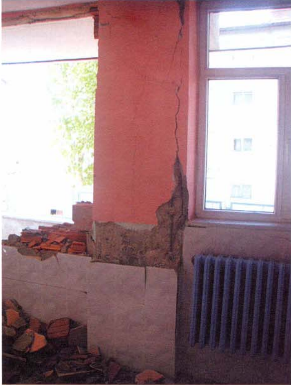
Deprem Sonrası Yurt Binası İçinden Bir Görüntü / BİNGÖL
