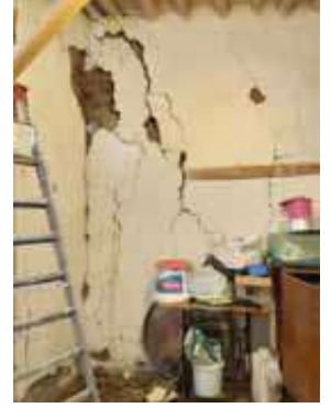
Şekil 10. Pütürge, Ağalar Mah., İncelenen Ev (Taşıyıcı Duvar Hasarı)
