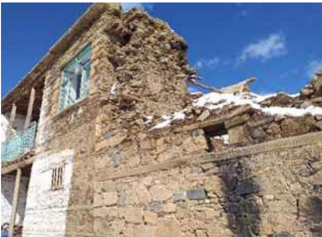
Şekil 2. Gökçe Köyü Kısmen Göçmüş 2 Katlı Yığma Ev, Ahşap Hatıllı Taş Duvarlar
