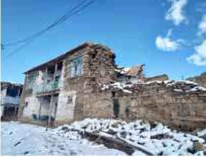
Şekil 8. Gökçe Köyü, Duvarlarda Düzlem Dışı Göçmeler
