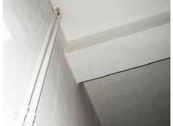
Şekil 21. Elazığ-Merkez, Az Hasarlı Betonarme Kısım (Elazığ Mesleki ve Teknik Anadolu Lisesi, Yapım Yılı-1969)
