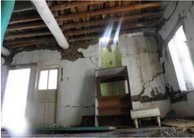
Şekil 4. Gökçe Köyü 2 Katlı Ev, Taşıyıcı Duvar Hasarı (İç Mekan)
