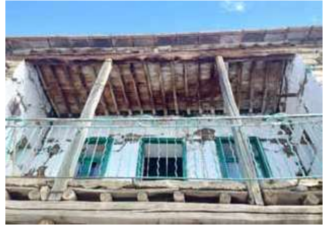
Şekil 5. Gökçe Köyü 2 Katlı Ev, Taşıyıcı Duvar Hasarı (Ön Cephe)
