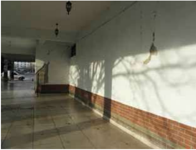
Şekil 25. Elazığ Şehirlerarası Otogarı Hasarları
