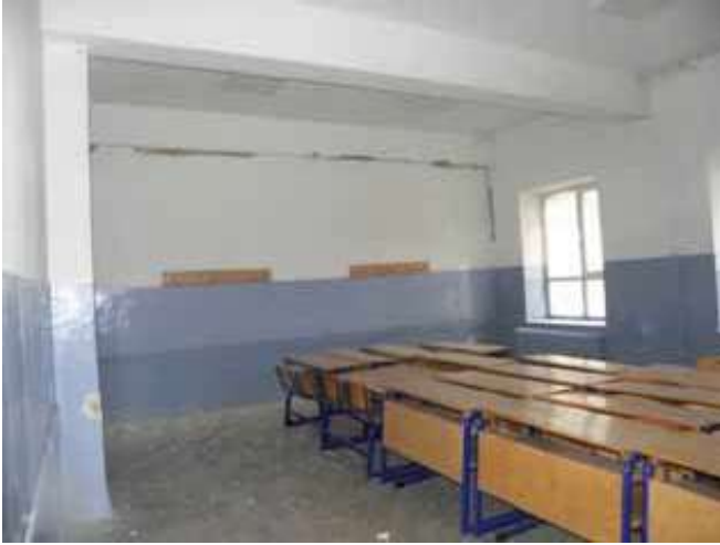
Şekil 20. Elazığ-Merkez, Az Hasarlı Betonarme Kısım, (Elazığ Mesleki ve Teknik Anadolu Lisesi, Yapım Yılı-1969)
