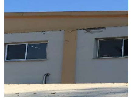
Şekil 6. Hatıllar ile bölünmüş cephe duvarlarında sınırlı hasar
