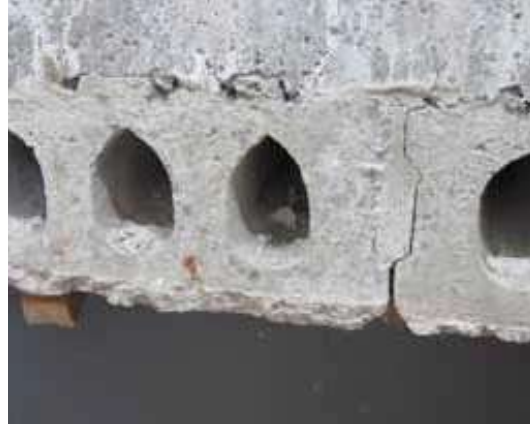
b) ÖBD elemanları birleşim kesitinde çatlak
