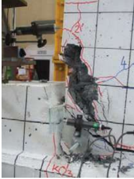
Hasarın düğüm noktası içine doğru ilerlemesi
