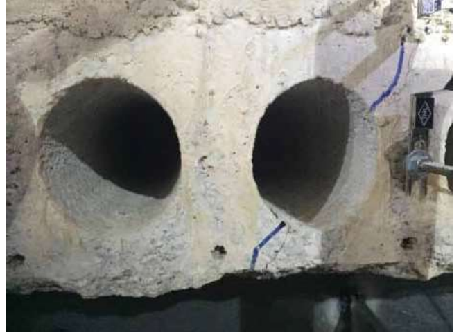
ÖBD kesitinde oluşan çatlaklar
